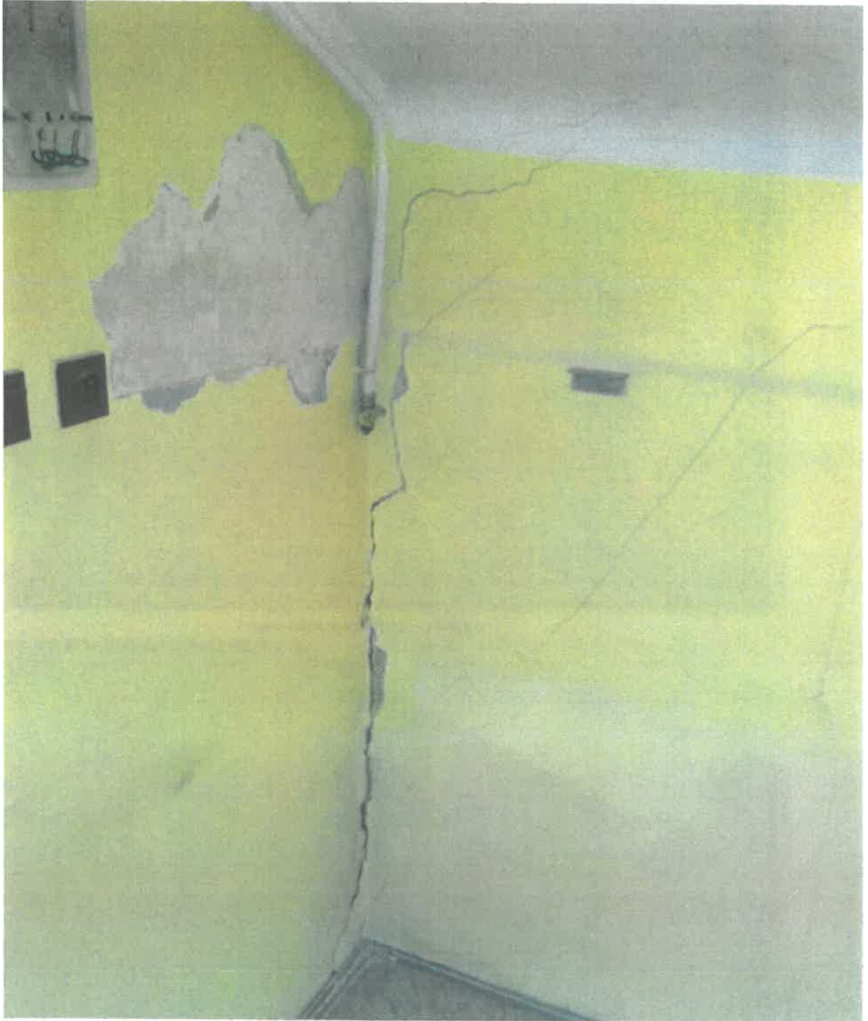
Fot/Rys - 3-18 Przykład uszkodzeń ścian
