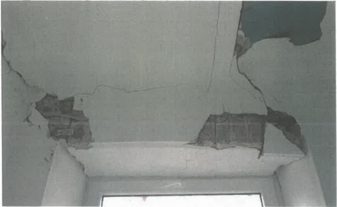
Fot/Rys - 3-12 Przykład uszkodzeń nadproża
