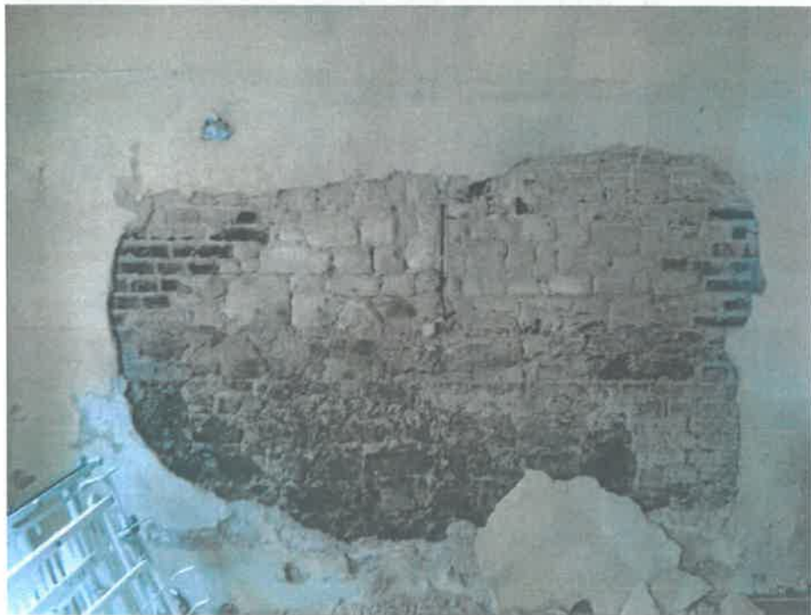
Fot/Rys - 3-8 Przykład uszkodzeń ścian
