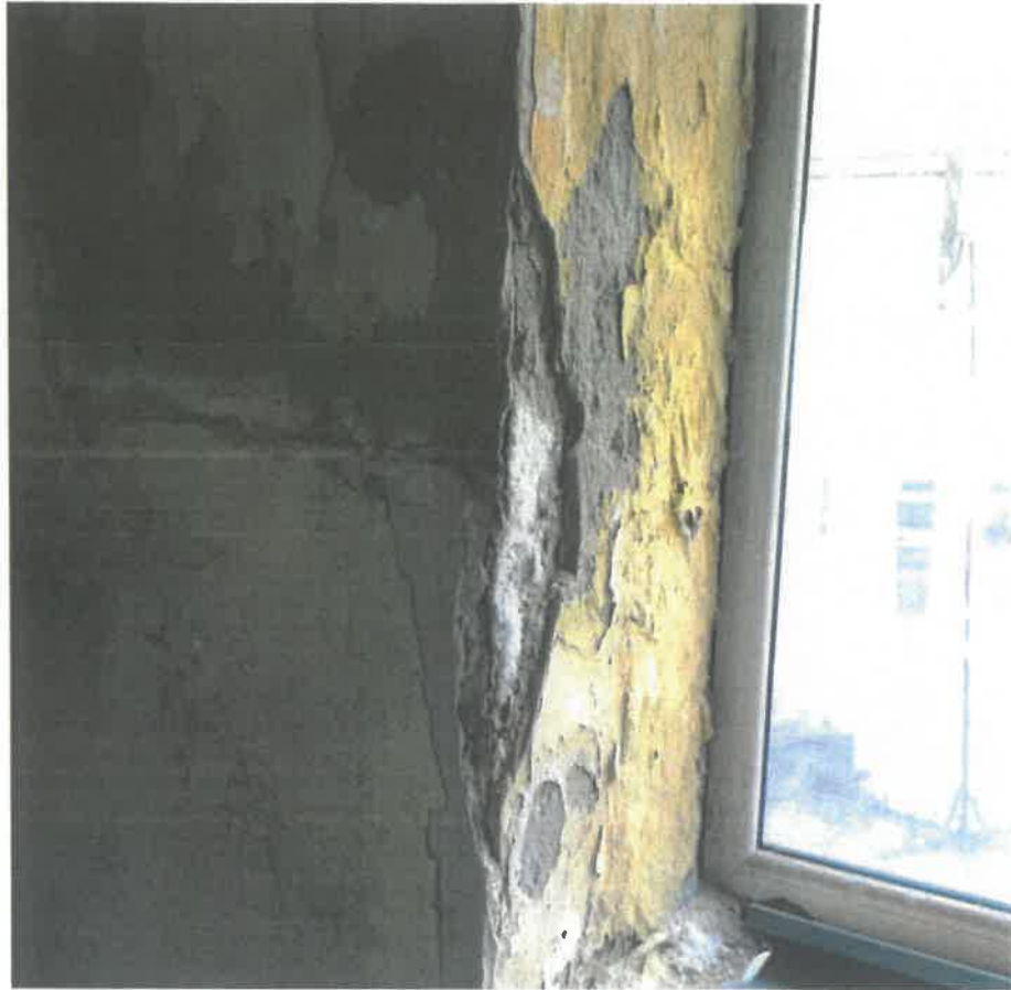
Fot/Rys - 3-7 Przykład uszkodzeń ścian
