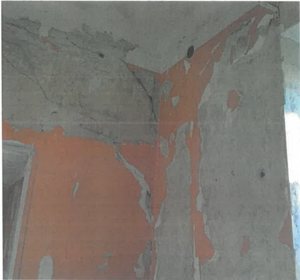
Fot/Rys - 3-14 Przykład uszkodzeń ścian
