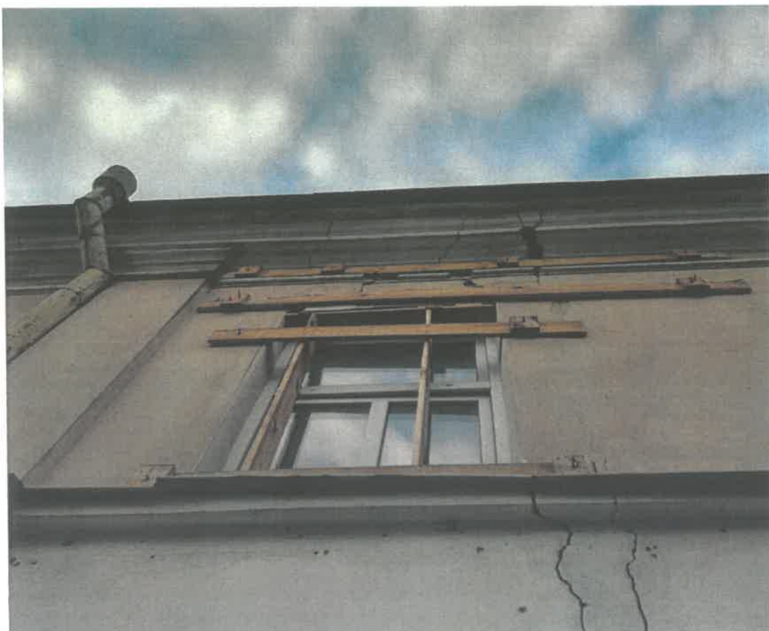
Fot/Rys - 3-23 Przykład uszkodzeń elewacji
