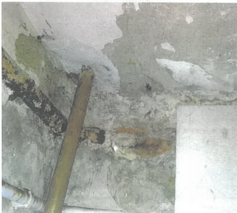
Fot/Rys - 3-5 Przykład uszkodzeń ścian
