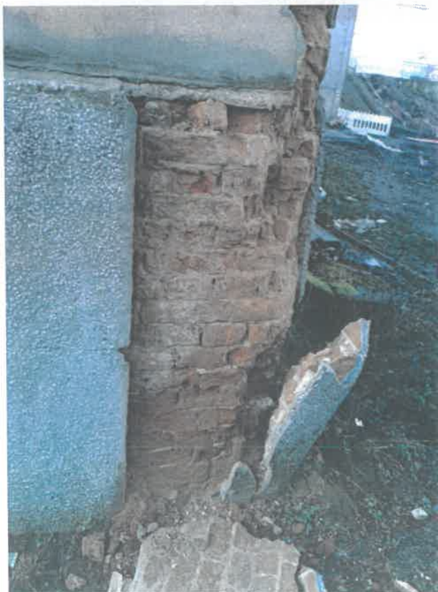
Fot/Rys - 3-24 Przykład uszkodzeń elewacji
