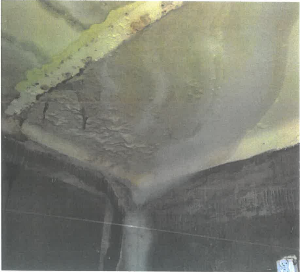
Fot/Rys - 3-9 Belka stropu Kleina, korozja biologiczna
